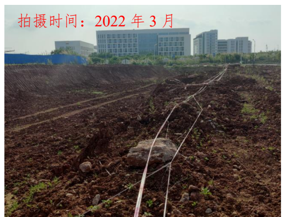
起点段附近局部扰动现状
