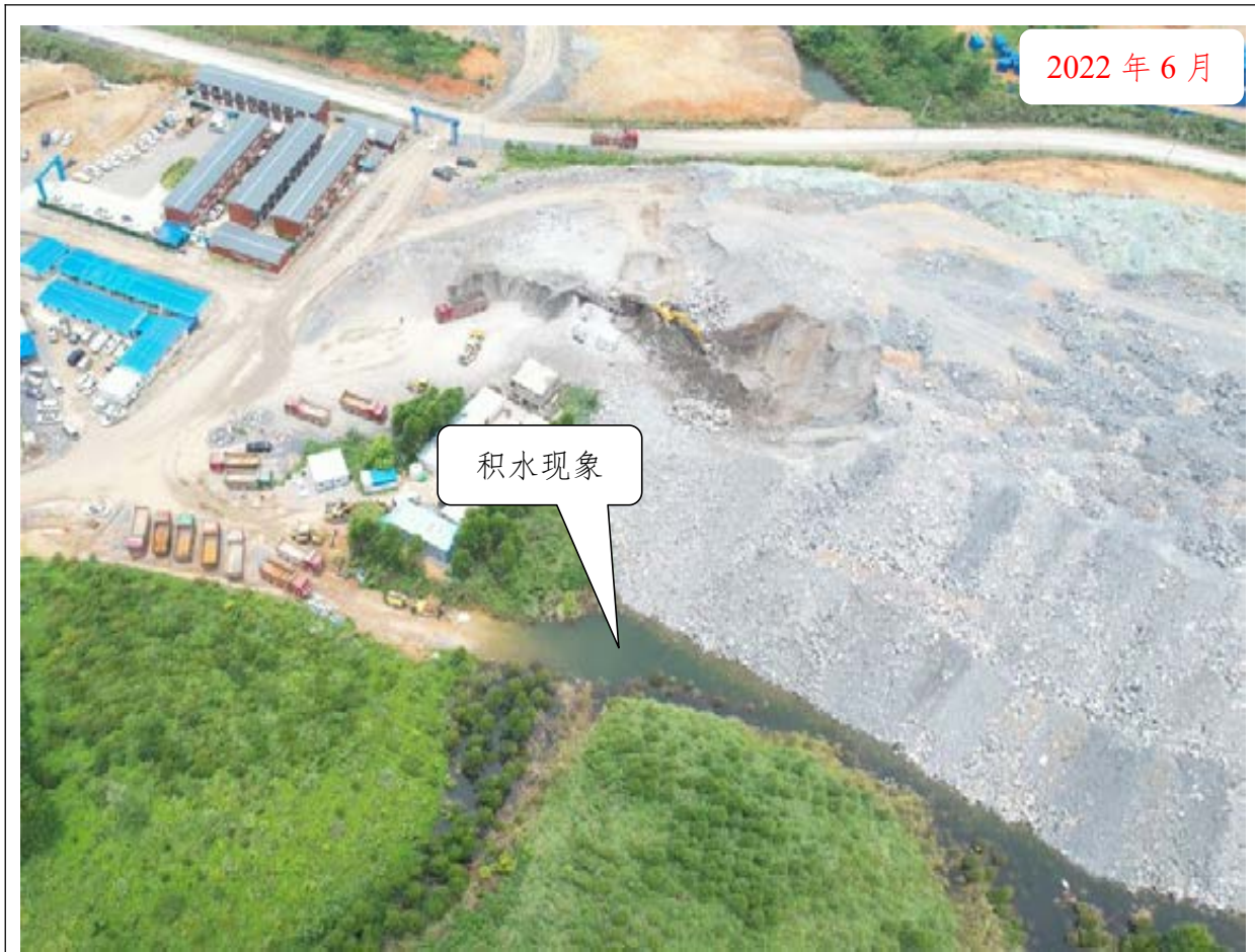
1#临时中转场区东侧积水现状
