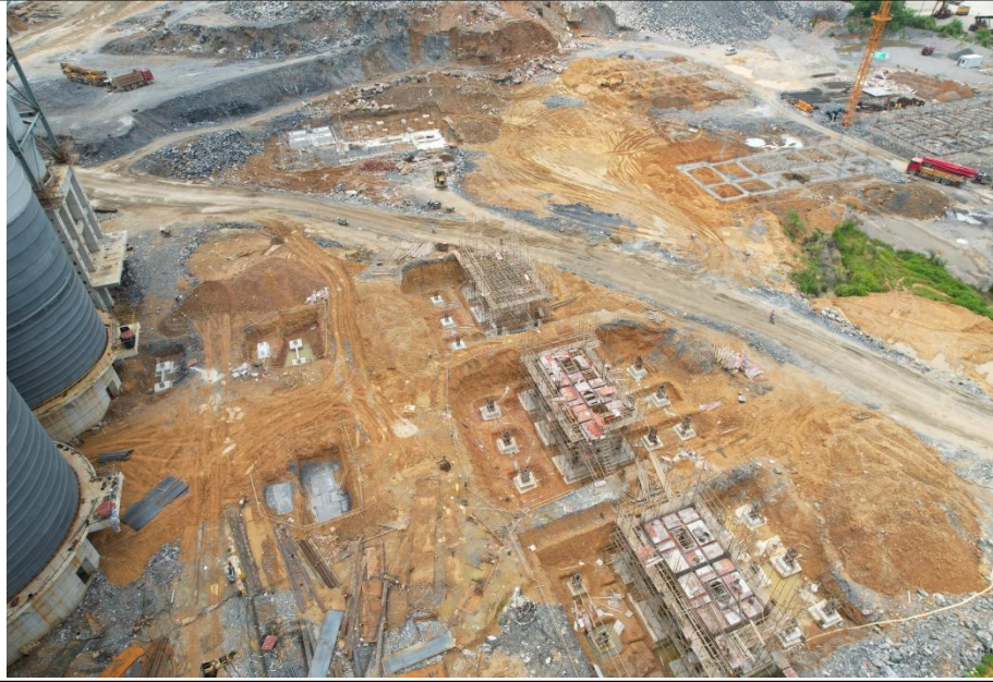
位置：主体工程区 成品储存及发运 区域西面，基础施 工裸露地表 拍摄时间：2022 年6月
