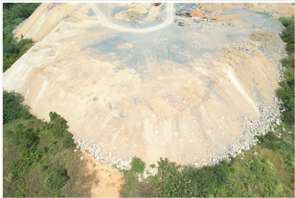
位置：2#临时中 转场土方裸露 现状 拍摄时间：2022 年 9 月
