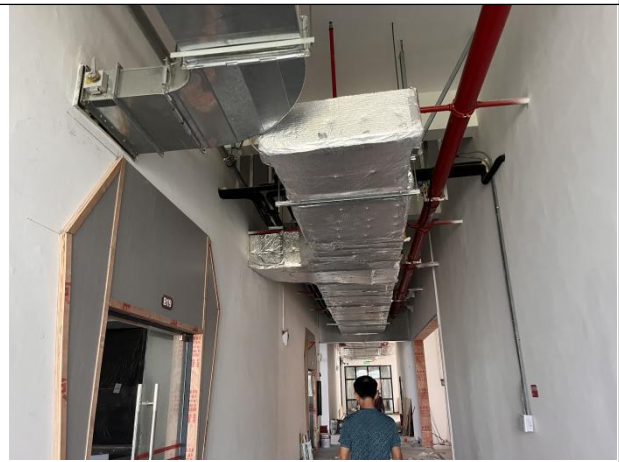
食堂油烟管道
